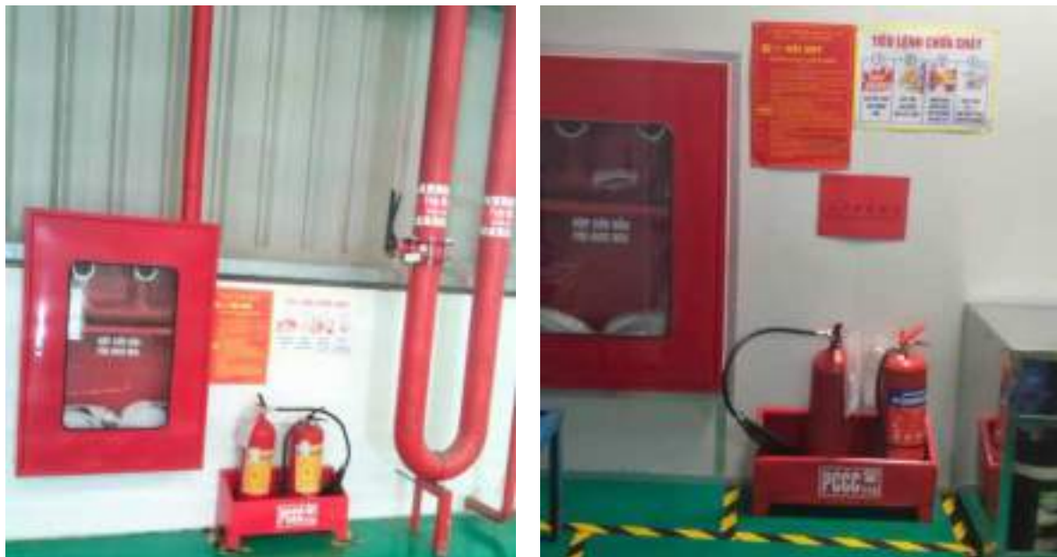
Hình 16. Hệ thống PCCC của dự án
