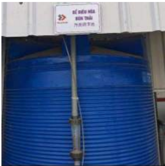
Bể điều hòa bùn thải
