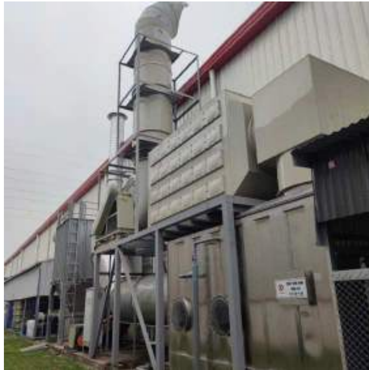
Hình 13. Hệ thống xử lý khí thải hữu cơ
