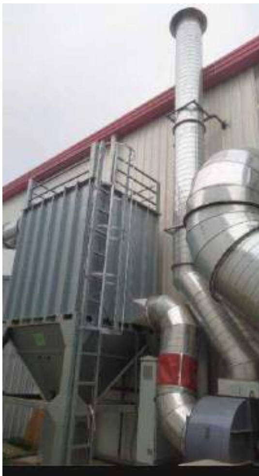
Hình 15. Hệ thống xử lý bụi của dự án
