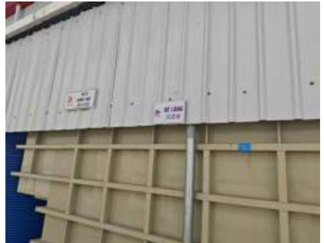
Bể xử lý nước thải + bể lắng
