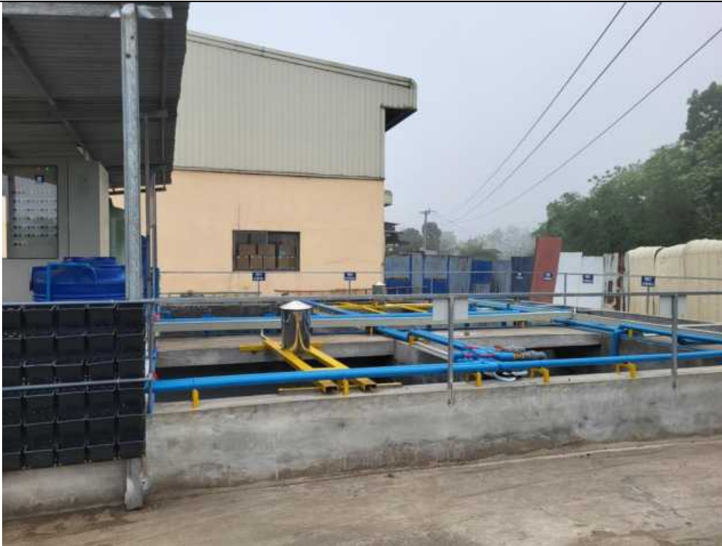
Hình 3. 8. Hệ thống xử lý nước thải tập trung công suất 200m³/ngày
